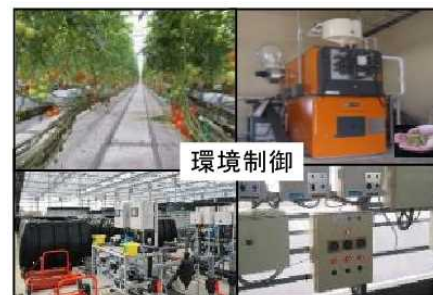
○高度環境制御装置
