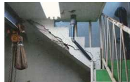
■老朽化の状況(中継ポンプ場)
