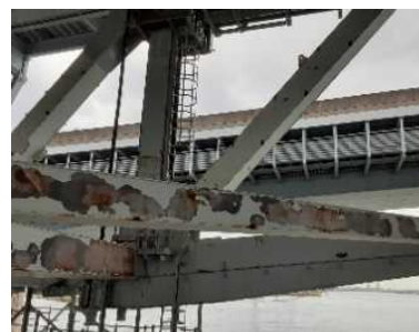
大規模な塗膜剥離・腐食 (R3年)
