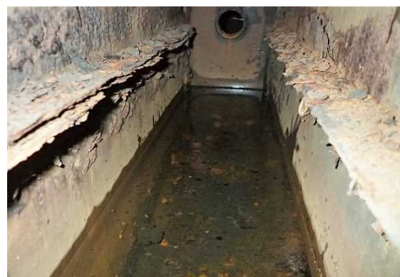
高欄内部の滞水
