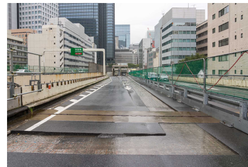
写真② 出入口閉鎖状況 (呉服橋入口付近)
