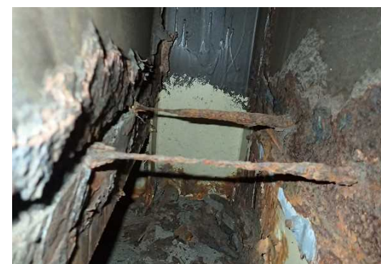
内部漏水・湿潤による腐食
