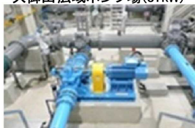
久御山広域ポンプ場(31kW)
