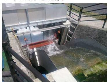
小水力発電施設
