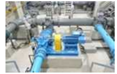
久御山広域ポンプ場(31kW)
