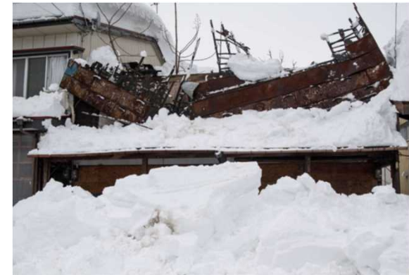
令和3年1月7日からの大雪（新潟県上越市）
