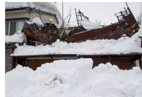
令和3年1月7日からの大雪（新潟県上越市）
