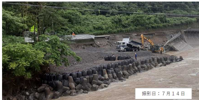
国道41号下呂市門坂地区道路流失
