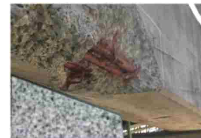
損傷状況(鉄筋露出)
