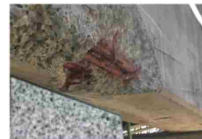
損傷状況(鉄筋露出)
