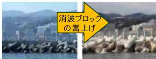
消波ブロックの沈下
