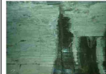
損傷状況(うき・漏水)
