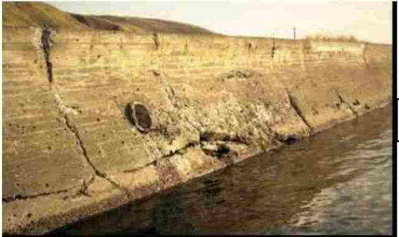
堤防の表法被覆工が損傷
