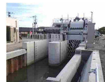
下水道施設(雨水ポンプ場)
