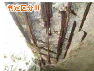
橋の裏側の鉄筋露出
