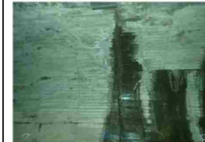
損傷状況(うき・漏水)
