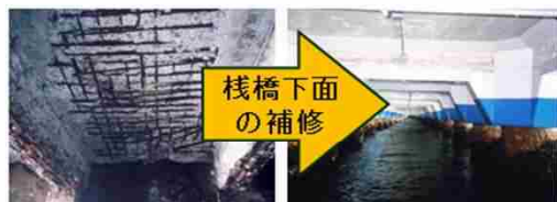
コンクリート劣化・鉄筋露出
