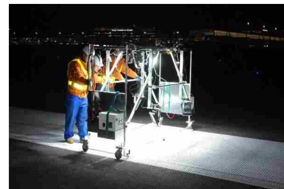
高解像度画像からのクラック自動抽出技術による空港の舗装巡回点検用モニタリングシステムの研究開発
