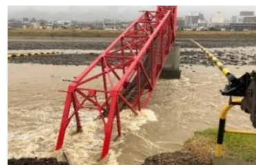
千曲川橋梁崩落状況（長野県長野市）
