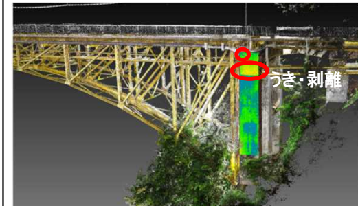
(例) 設計CADデータと点群データの 偏差解析から損傷箇所を見える化
