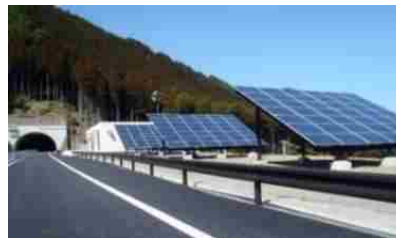
道路空間の太陽光発電設備
