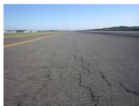
(舗装のひび割れが発生)
