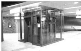
エレベーター
