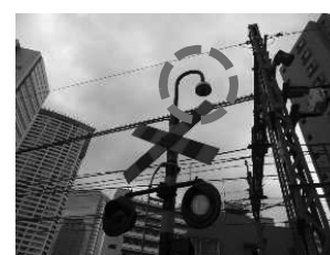
踏切監視用カメラ
