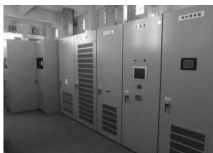
鉄道施設内に設置した電力貯蔵装置
