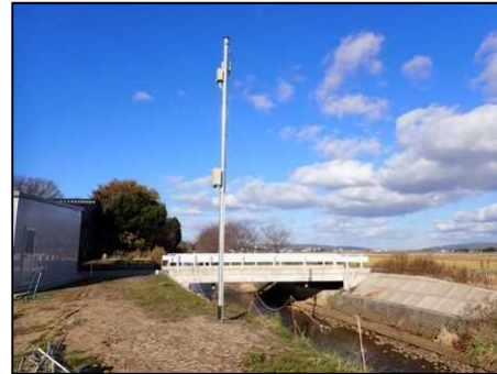
河川監視カメラの整備、改良
