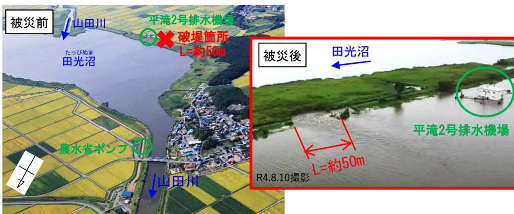
令和4年8月3日からの大雨等による被害（青森県山田川）
