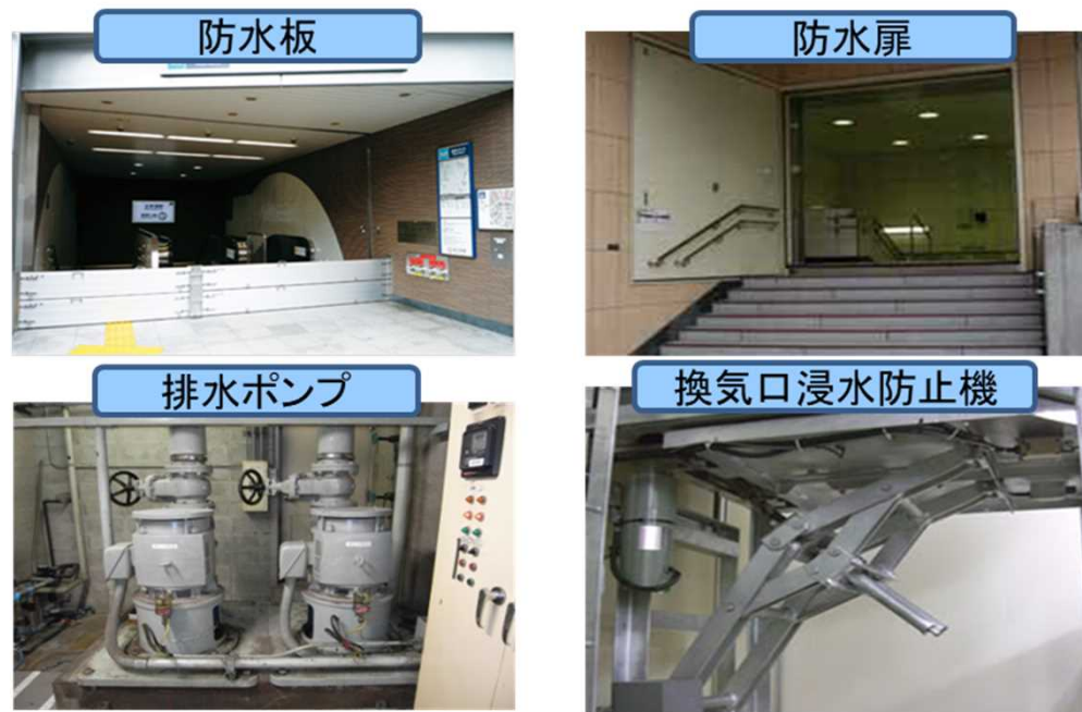
対象となる浸水防止用設備
