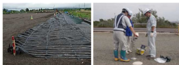
軟弱地盤上の盛土を補強するためのグラベル基礎補強工法
