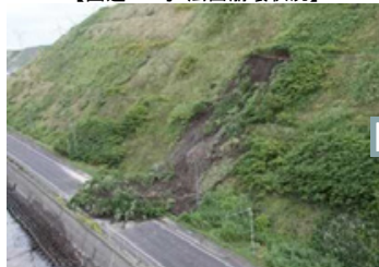
【国道232号 法面崩壊状況】
