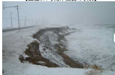
【国道238号海岸浸食の状況】
