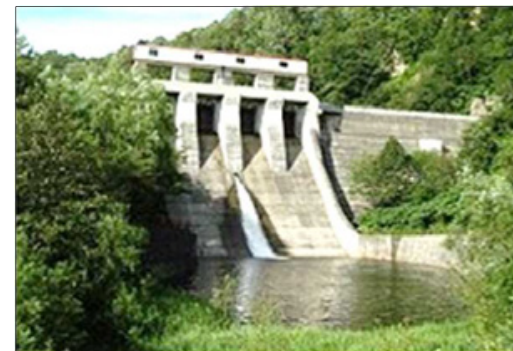
雨竜川ダム再生事業 (雨竜第二ダム(幌加内町)) (堤体かさ上げ・容量振替予定)
