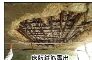
床版鉄筋露出
