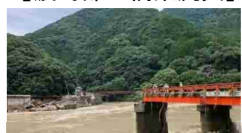
令和2年7月豪雨、熊本県道
