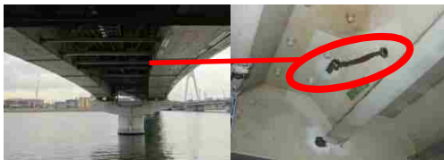
縦リブ等に多数の疲労亀裂が発生
