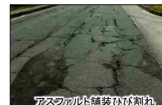
アスファルト舗装ひび割れ
