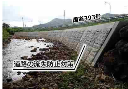
あぶたくん くちやんちよう 北海道虻田郡倶知安町 道路の流失防止対策
