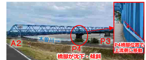
令和3年5月の大雨 (川島大橋：岐阜県)
