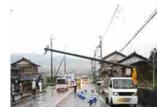
沿道の電柱の倒壊による道路閉塞
