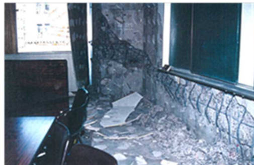
内部の被災状況
