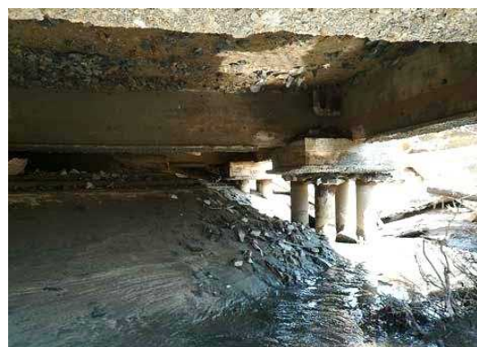
建物基礎が露出
