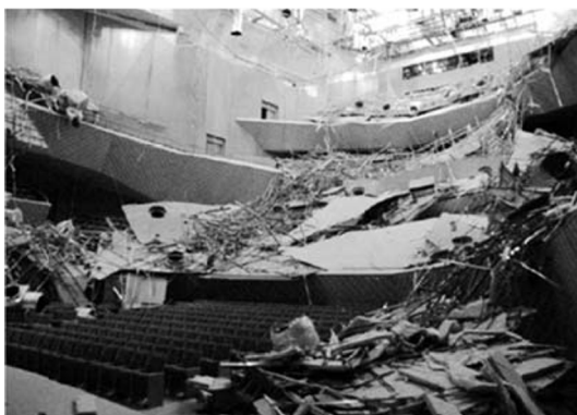
ホール天井の脱落
