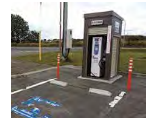
道の駅「もち米の里☆なよろ」のEV急速充電器
