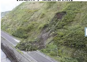
【国道232号 法面崩壊状況】
