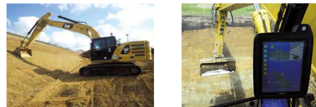
道路の新設工事におけるICT建設機械での切土法面の掘削状況
