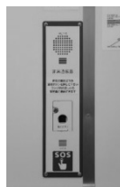
非常通報装置の例
