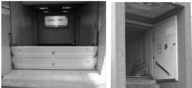
止水板・防水扉の整備
