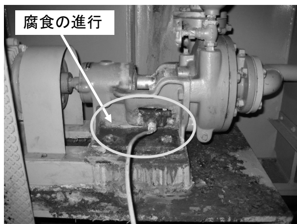
排水設備の劣化
