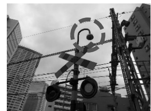
踏切監視用カメラ
