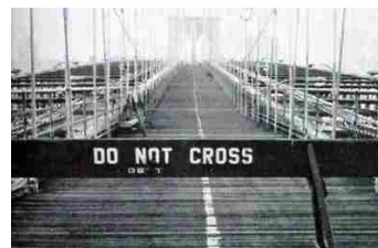
ケーブル切断事故後、通行止めになったブルックリン橋の歩道 (「高速道路と自動車」1981年11月から引用)
