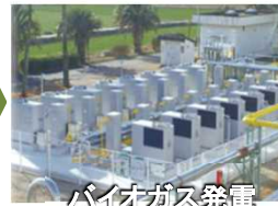
バイオガス発電
