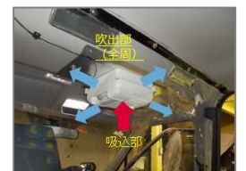
車内への空気清浄フィルタ等の設置による感染症対策
