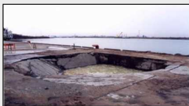
陥没した港湾施設のエプロン部
