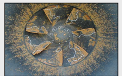
腐食した排水ポンプ場の羽根車
