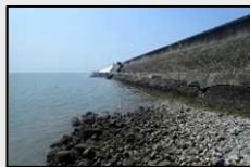
老朽化した海岸堤防
