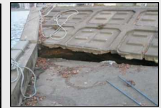
クラックが生じた河川護岸
