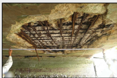
内部の鉄筋が露出した橋梁
