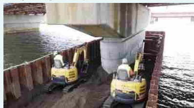
【橋梁の耐震補強（国道38号釧路大橋）】 地震後、橋としての機能を速やかに回復でき支障ルートや避難ルートとして活用が可能。
