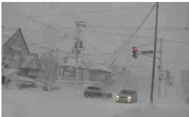
暴風雪による電線の破断 （網走市 国道244号）
