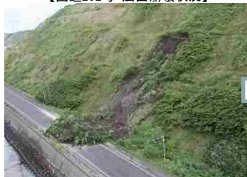
【国道232号 法面崩壊状況】
