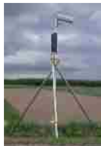
災害の切迫情報を伝える簡易型河川監視カメラの設置 (常呂川)
