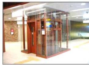
エレベーター
