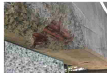
損傷状況(鉄筋露出)
