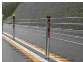
<ワイヤロープの設置事例>
