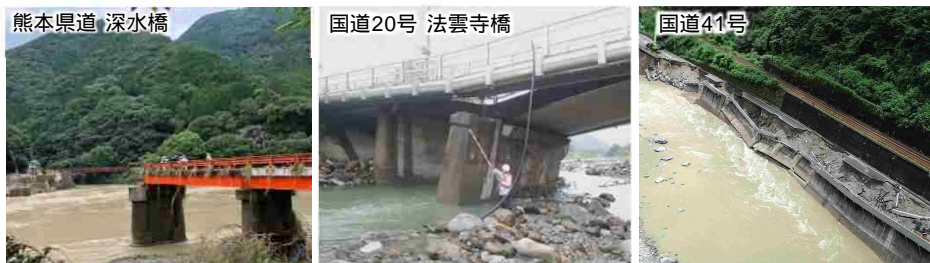
熊本県道 深水橋 橋梁流失 令和2年7月豪雨 (3ヶ月以上の通行止め) 国道20号 法雲寺橋 橋脚洗掘・沈下 令和元年台風19号 (1ヶ月半の通行止め) 国道41号 道路流失 令和2年7月豪雨 (1ヶ月半の通行止め)
