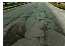
<劣化状況(国道)>
