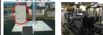
<無停電装置> <自家発電装置>
