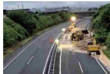
九州自動車道(横川～溝辺鹿児島空港)の被害状況
