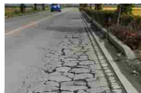
<劣化状況(地方道)>
