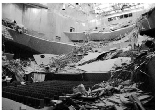
ホール天井の脱落
