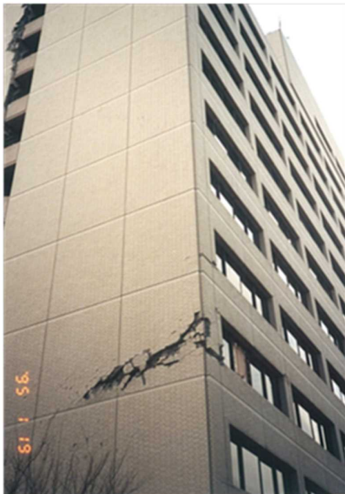
〔柱が破断するなど構造体が損傷し、機能の復旧に時間を要した〕
