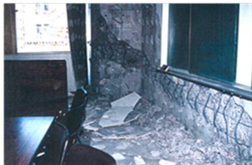
内部の被災状況
