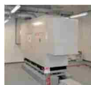
非常用発電設備 (高層階に設置)
