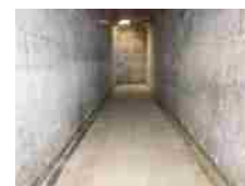
雨水貯留施設
