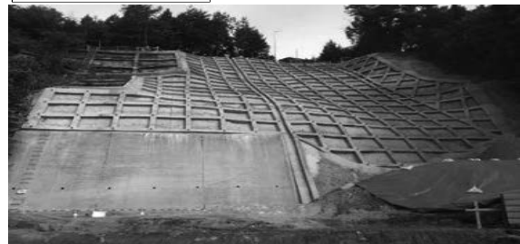
コンクリート枠による斜面の補強
