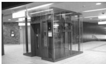
エレベーター
