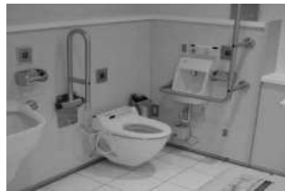
障害者対応型トイレ
