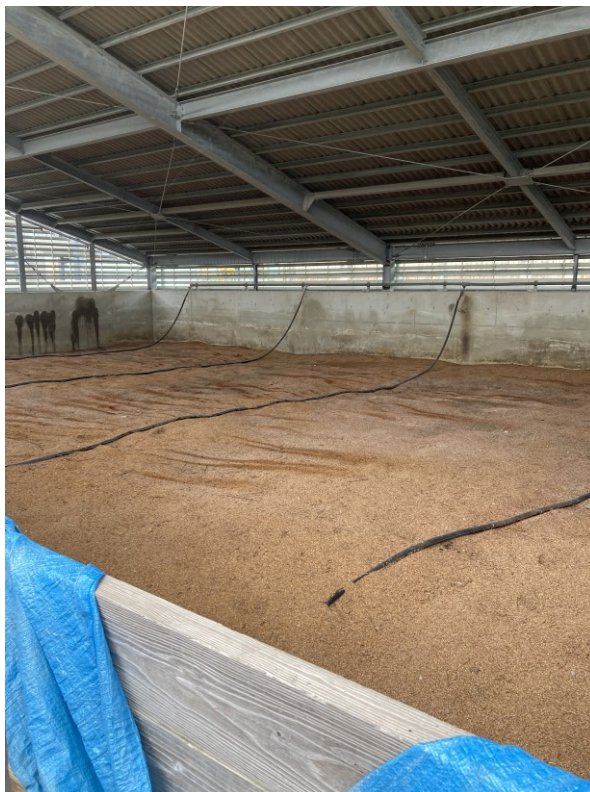
図 II-3 生物脱臭装置
