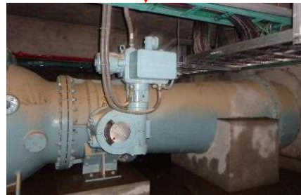
被災したポンプ吐出弁電動機
