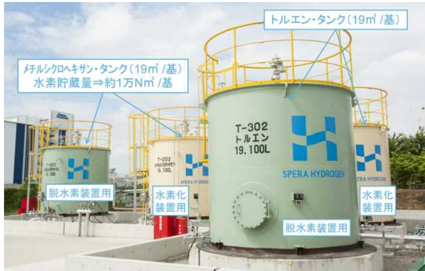
資料:「SPERA 水素 千代田の水素供給事業」、千代田化工建設株式会社 図 9:有機ハイドライドタンク(実証段階)
