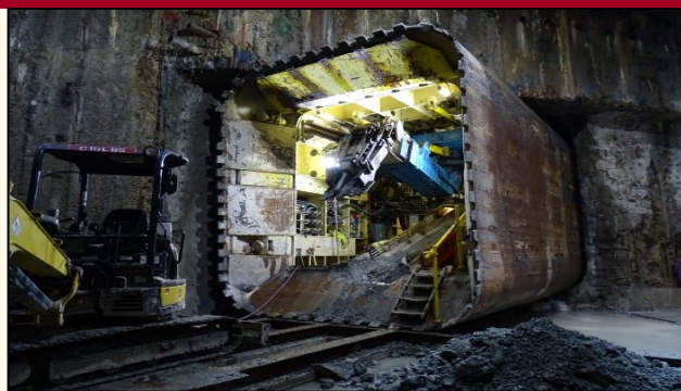
開放型矩形シールド機の到達状況写真(歩行者トンネル)
