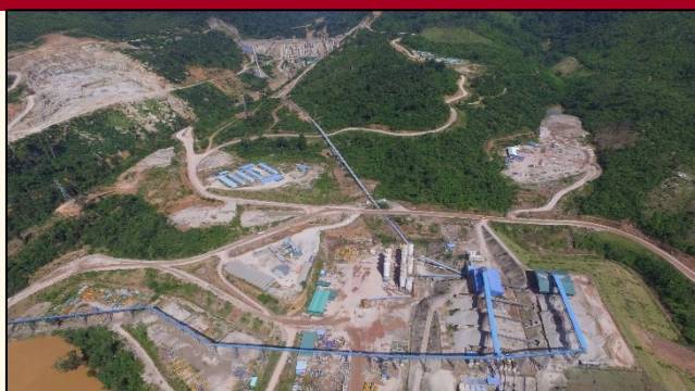
コンクリート生産・運搬設備
