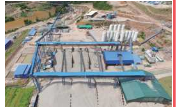
RCCプラント
