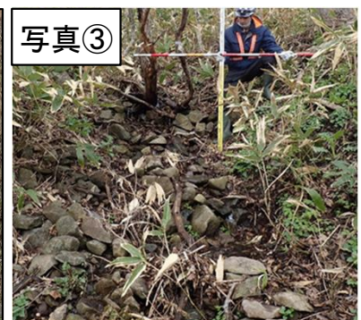
R6.4.17点検時に認められた自然斜面の不安定な転石
