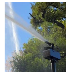
(放水銃) 近隣火災から護るための 放水銃、ドレンチャー 等
