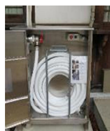
(易操作性1号消火栓) 初期消火、火災の拡大を防ぐための 消火栓施設 等
