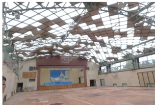
台風で屋根が消失した体育館
