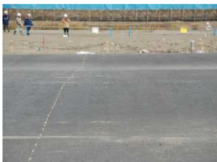
例写真-3.1 液状化後のアスファルト舗装の変状
