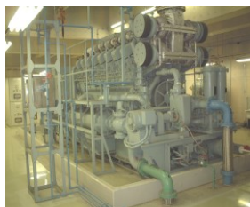
非常用発電設備
