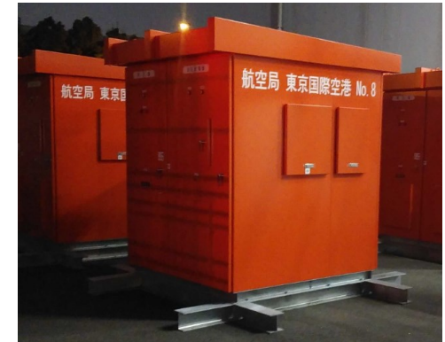
移動式受配電設備
