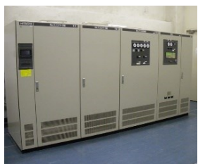
無停電電源設備
