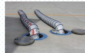
エアコン用ピット
