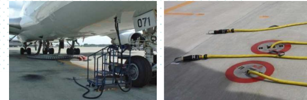
電力供給の様子
