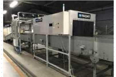
BHS内荷物用除菌装置
