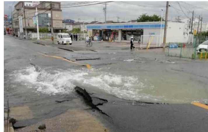
水道管が破断して水が噴き出した道路
