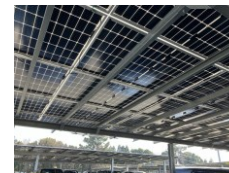
太陽光パネル
