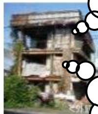
外壁が崩壊等した事例 (出典：国土交通省資料)
