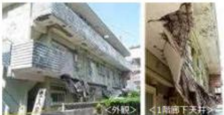
2階の廊下部分が崩落した事例
