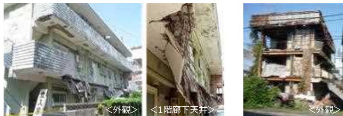
2階の廊下部分が崩落した事例
