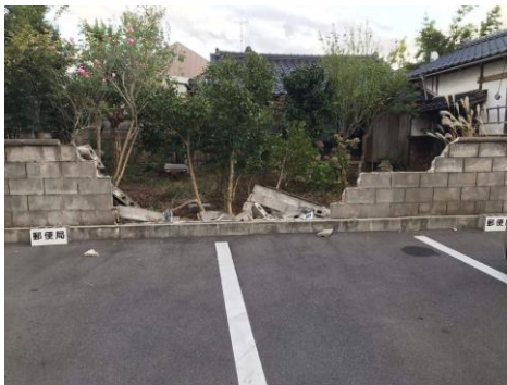
【写真 16 管理不十分な空き家①】
