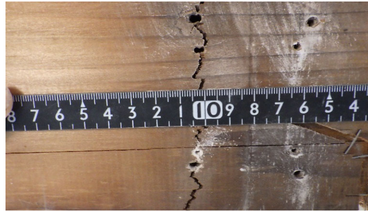
No.B-R5-1-120 破壊部分の状況
