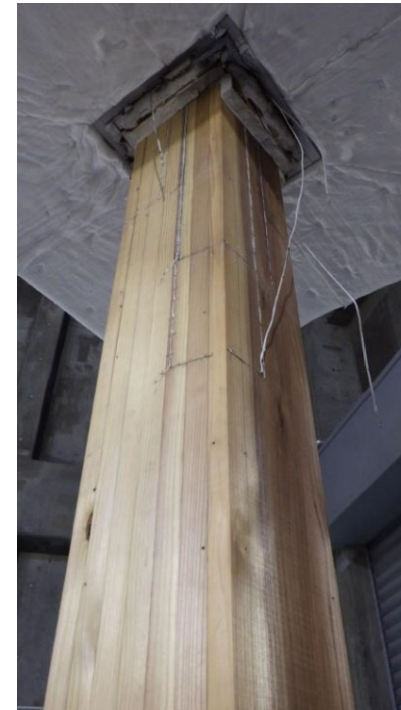
加熱後 木部の状況
