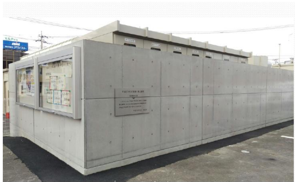
コンクリート壁で浸水対策を施した非常用発電設備
