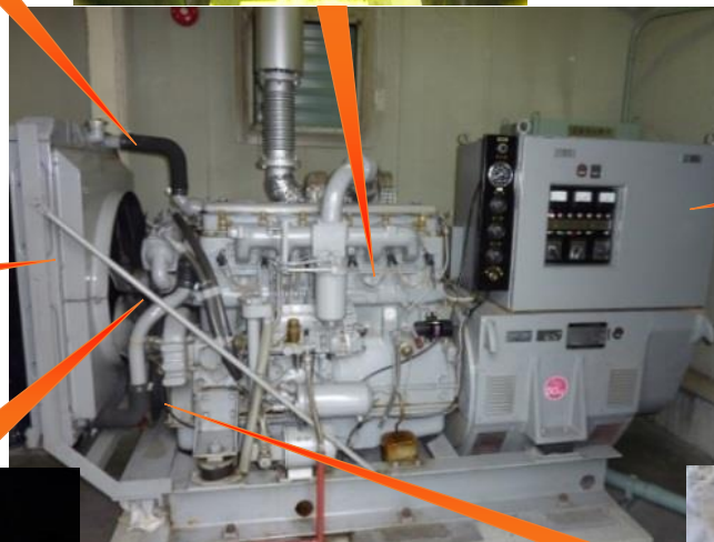
非常用自家発電設備
