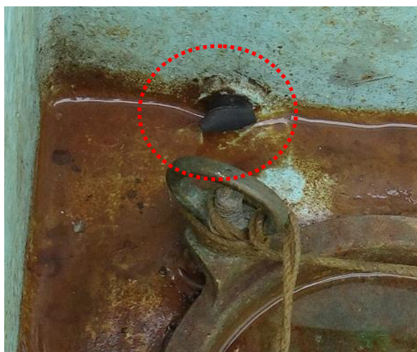
写真4 プロペラ点検口の船首側囲壁下部の穴 (船体調査時には、穴にゴム栓が取り付けられていた。)
